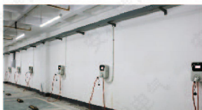
电动车充电桩
